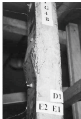
Figura 22 Flambagem e descolamento da chapa de aço.
