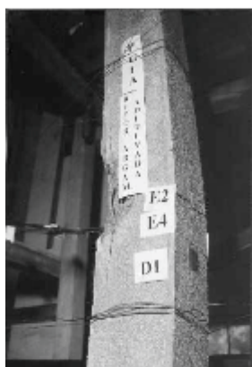
Figura 20 Ruptura do pilar reforçado com argamassa com adição de sílica ativa.
