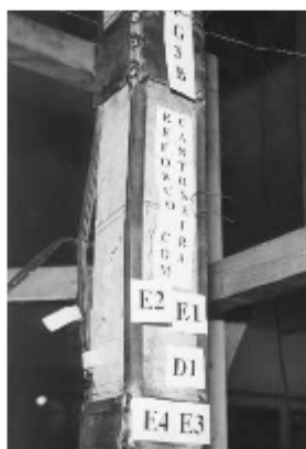
Figura 21 Flambagem das cantoneiras do pilar reforçado com perfis metálicos.
