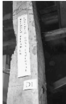
Figura 24 Pilar reforçado com concreto armado em 3 faces, esmagamento do concreto.
