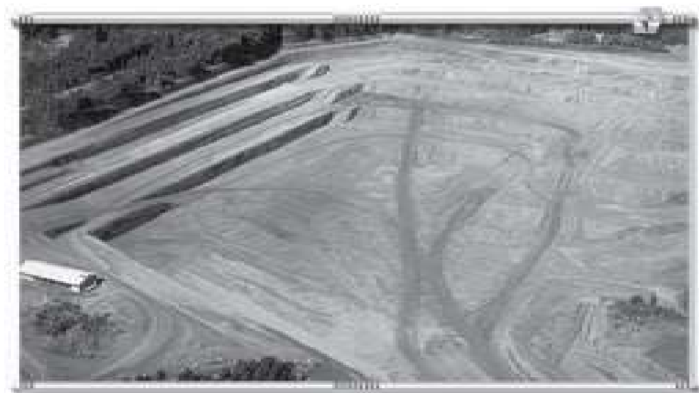
Figura 1 - Vista geral das frentes de lavra de extração de Pirocloro em Araxá, MG.
