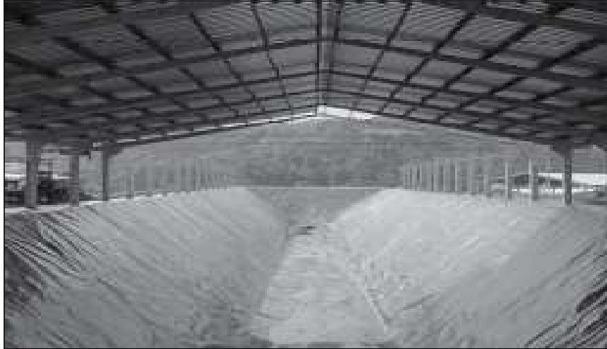
Figura 2 - Vista geral da vala de destinação final da classe I, com a cobertura em implantação.
