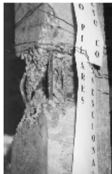
Figura 23 Flambagem das armaduras do pilar reforçado com concreto armado nas 4 faces.
