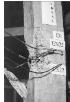
Figura 25 Ruptura do pilar reforçado com concreto armado em 2 faces opostas.
