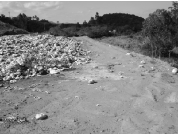
Figura 06: Um espaldão contém os resíduos, mas não há isolamento para conter o percolado.
