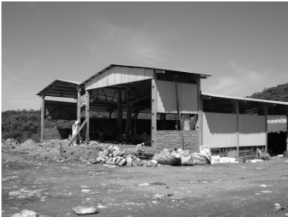
Figura 01: Instalações para separação dos RSUD. Fonte: Pesquisa realizada.
