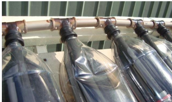
Figura 9 - Conexões queimadas Fonte: Autores, 2012
